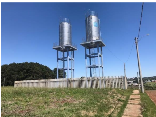
Figura 27 – Reservatório Elevado – Rua Leonardo Dias da Silva (100 m3)
