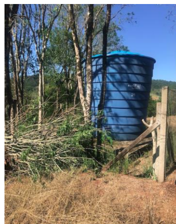
Figura 30 – Reservatório Elevado – (20 m3)
