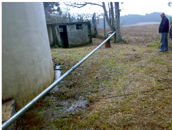
Figura 31: Poço do Aquífero Serra Geral situado na área da barragem do rio Campo.
