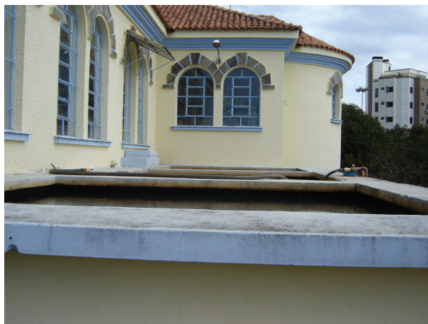
Figura 42: Filtros da ETA 1 de fluxo descendente.
