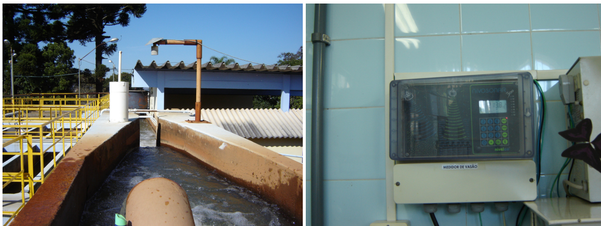
Figura 95: ETA 1 macromedidor ultrasônico na calha Parshall e conversor na sala do laboratório.
