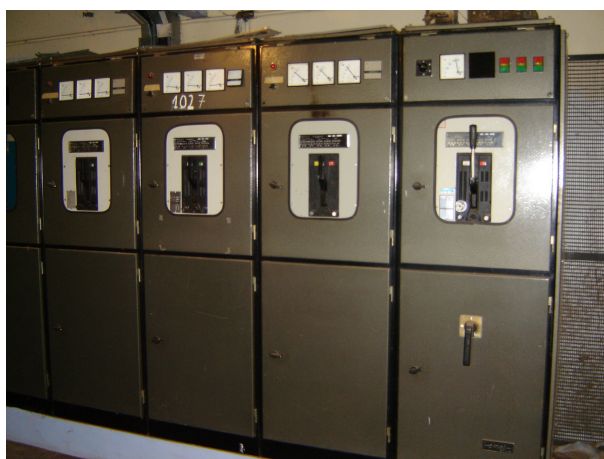
Figura 70: Quadro de comando dos motores partida direta.
