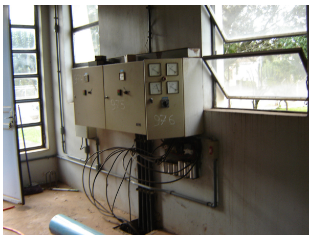
Figura 82: Quadro de comando dos motores partida direta.
