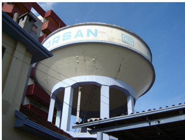
Figura 90: Reservatório elevado de 150 m 3 da Rua Portugal.
