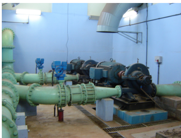
Figura 75: Elevatória de água tratada da ETA 2 para o RET da ETA 1.
