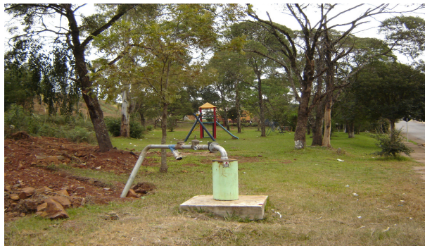
Figura 29: Poço do Aquífero Serra Geral situado à Rua Hermínio Vitor.
