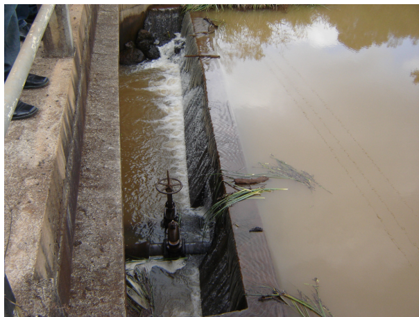
Figura 33: Duas tubulações de Ø 200 mm que vão ao poço de sucção da elevatória da barragem do rio Campo.
