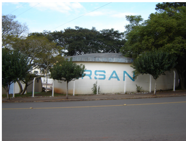
Figura 91: Reservatório apoiado de 1.500 m 3 da Rua Polônia.
