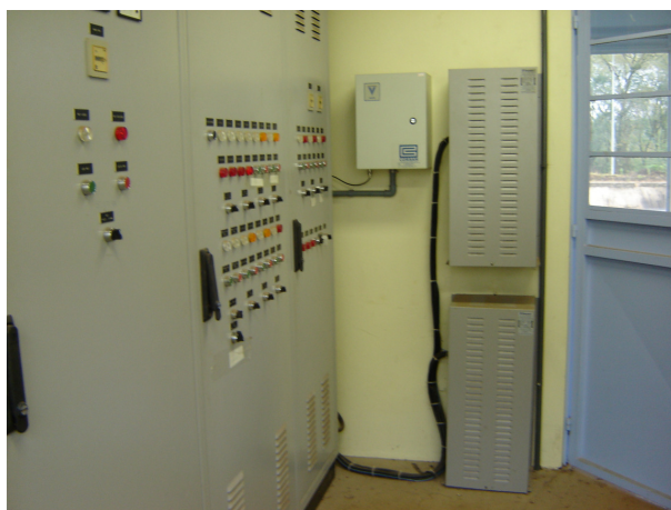
Figura 74: Quadro de comando dos motores partida por soft-start.
