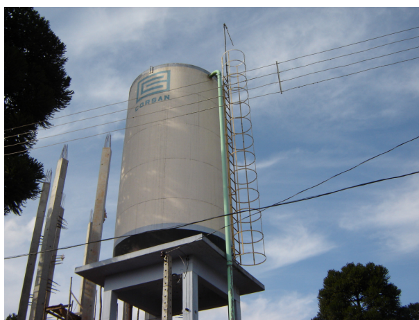
Figura 94: Reservatório elevado de 50 m 3 da Rua Francisco Strovonski e ao lado estrutura de concreto do novo elevado de 500 m 3 que está sendo construído.
