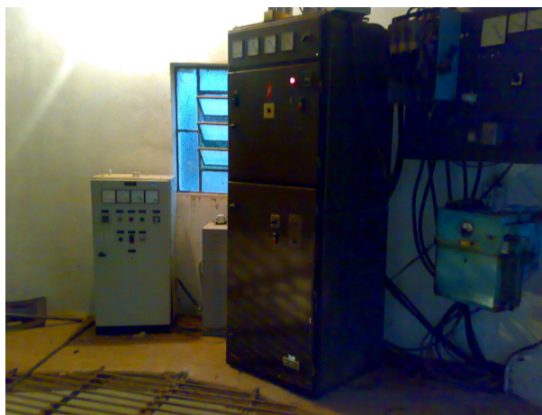
Figura 68: Quadro de comando dos motores partida direta.
