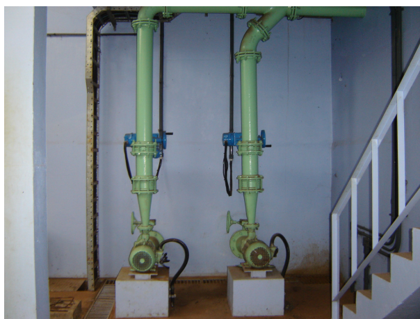
Figura 73: Elevatória de água tratada para o REL da ETA 2.
