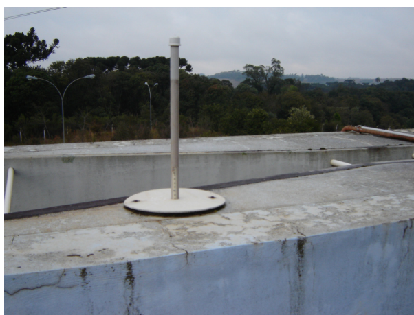
Figura 96: Régua de medição de nível na calha Parshall da ETA 2.
