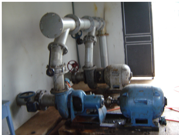
Figura 81: Elevatória de água tratada da rua Polônia para o reservatório elevado da rua Soledade.
