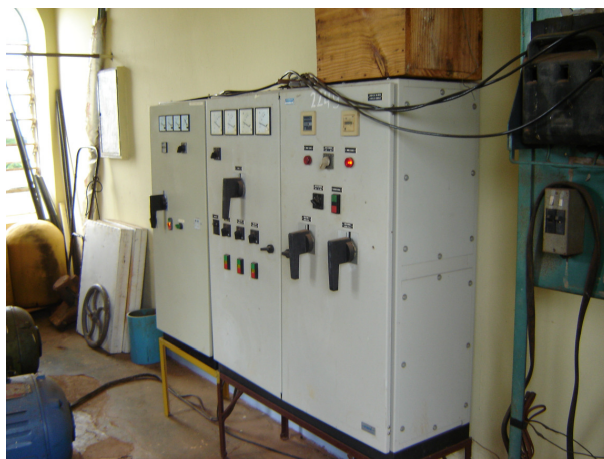
Figura 78: Quadro de comando dos motores partida direta.
