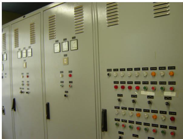
Figura 76: Quadro de comando dos motores por soft-start.
