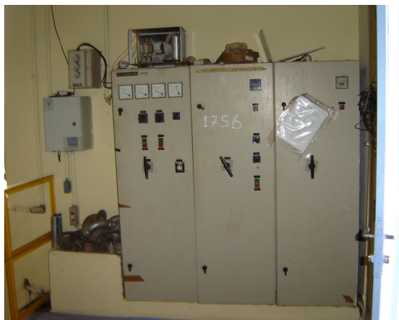
Figura 80: Quadro de comando dos motores partida direta.
