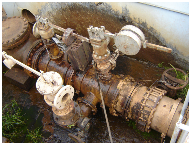
Figura 36: Tubulação de Ø 450 mm que transporta água bruta para a ETA 1 e o sistema de alívio de transiente hidráulico.
