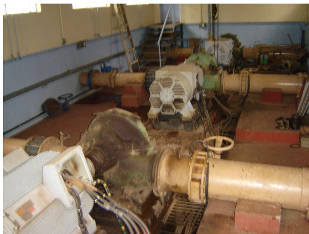
Figura 69: Elevatória de água bruta para ETA 1.
