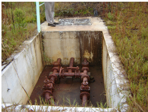
Figura 58: Elevatória da lagoa de decantação de lodo.
