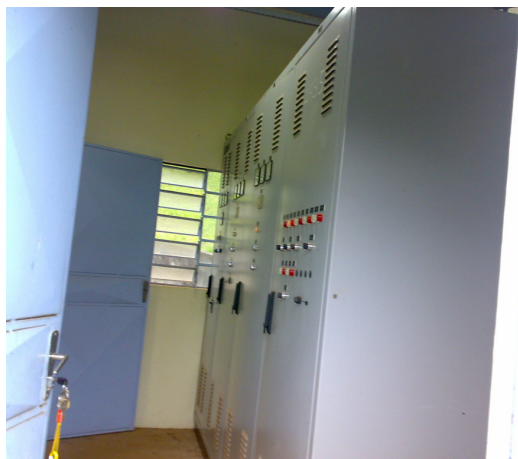
Figura 72: Quadro de comando dos motores partida por soft-start.
