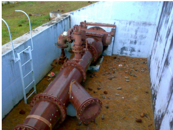
Figura 38: Tubulação de Ø 350 mm que transporta água bruta para a ETA 2 e o sistema de alívio de transiente hidráulico.
