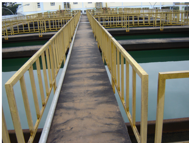
Figura 55: Filtros da ETA 2.
