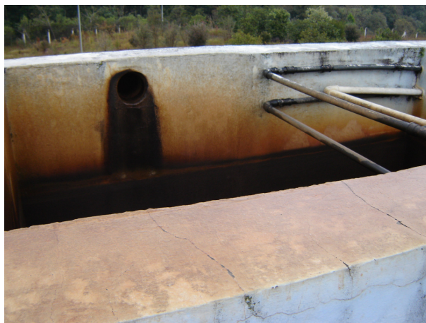
Figura 59: Chegada da água da lagoa na entrada da Calha Parshall.
