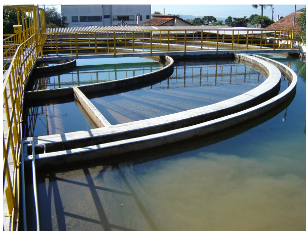
Figura 41: Decantador circular da ETA 1, placas de cimento amianto e calhas de coleta de água decantada afogadas.
