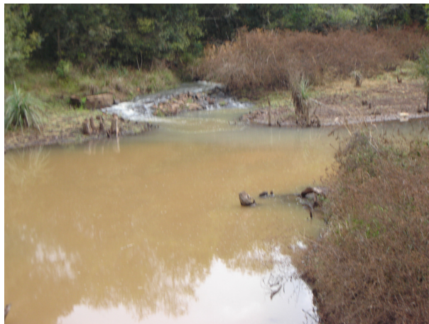
Figura 34: Chegada da adutora de 375 mm no reservatório da barragem formado pelos rios Leãozinho e Ligeirinho.
