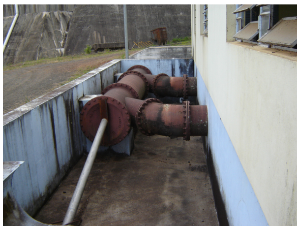
Figura 37: Tubulação de Ø 500 mm que alimenta os 2 conjuntos moto bomba da elevatória da barragem dos rios Leãozinho e Ligeirinho.
