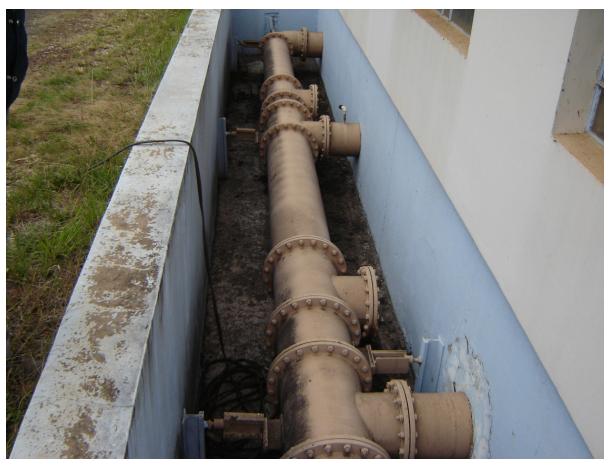
Figura 35: Tubulação de sucção Ø 500 mm que alimenta os 3 conjuntos moto bomba da elevatória da barragem dos rios Leãozinho e Ligeirinho.
