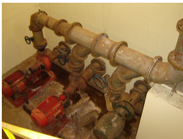
Figura 79: Elevatória de água tratada da ETA 1 para os reservatórios das ruas Portugal e Polônia.
