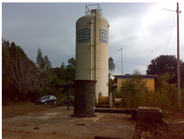
Figura 32: Poço do Aquífero Guarani.
