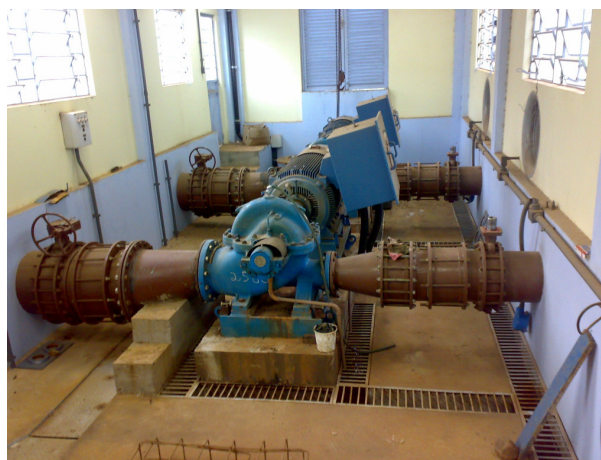
Figura 71: Elevatória de água bruta para ETA 2.
