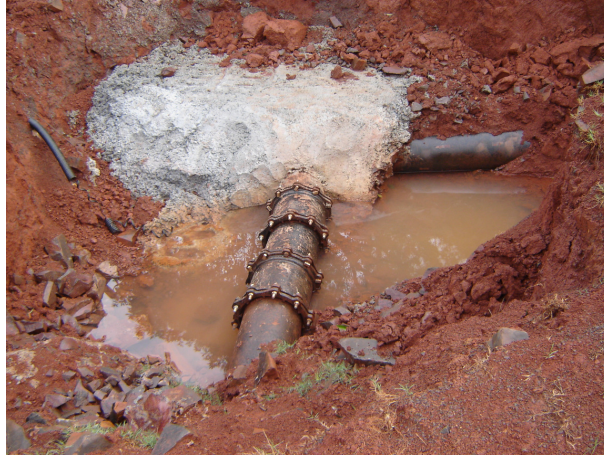
Figura 66: Adutora de recalque da ETA 2 para ETA 1.
