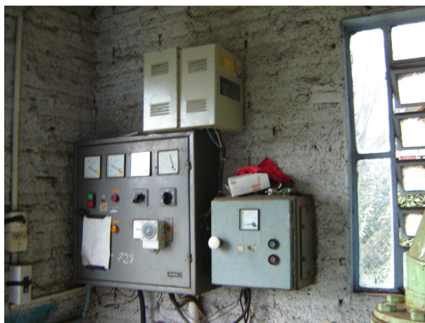
Figura 84: Quadro de comando dos motores partida por timer.
