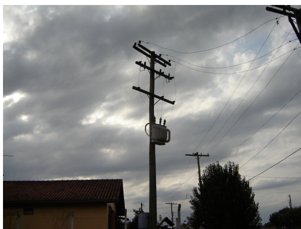
Figura 86: Transformador de tensão no booster Presidente Vargas.
