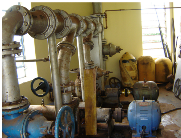
Figura 77: Elevatória de água tratada para o REL da ETA 1.
