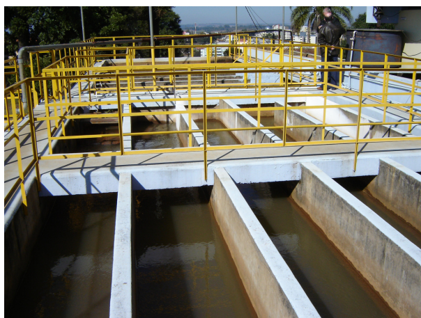
Figura 40: Floculadores verticais de fluxo horizontal.
