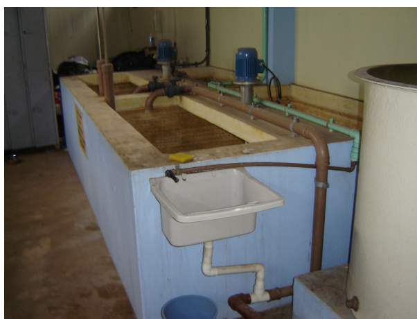
Figura 63: Reservatório de Sulfato de Alumínio Líquido.
