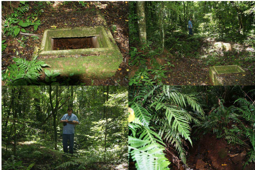
Figura 45 - Tubulação de Esgoto Sanitário Inserida no Parque Natural Municipal Longines Malinowski, Erechim – RS.
