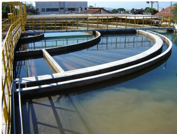
Figura 41: Decantador circular da ETA 1, placas de cimento amianto e calhas de coleta de água decantada afogadas.
