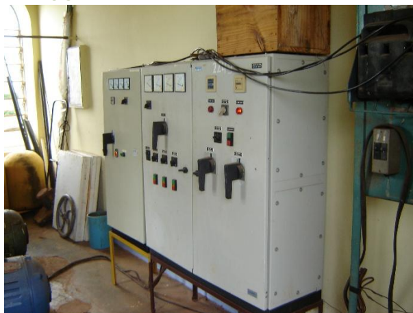
Figura 81: Quadro de comando dos motores partida direta.
