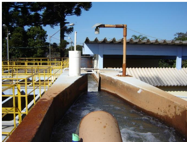
Figura 39: Calha Parshall da ETA 1, medidor de vazão e aplicação de coagulante.
