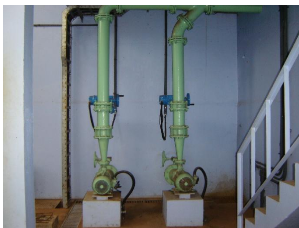
Figura 77: Elevatória de água tratada para o REL da ETA 2.
