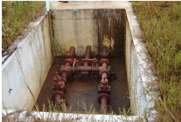
Figura 62: Elevatória da lagoa de decantação de lodo.
