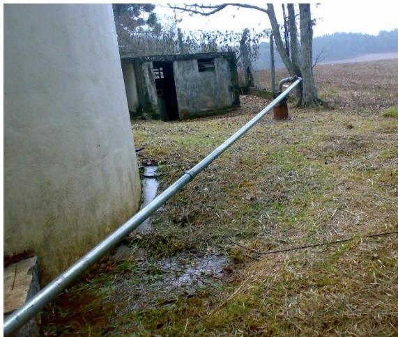
Figura 31: Poço do Aquífero Serra Geral situado na área da barragem do rio Campo.
