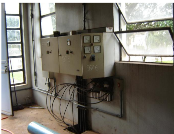
Figura 85: Quadro de comando dos motores partida direta.
