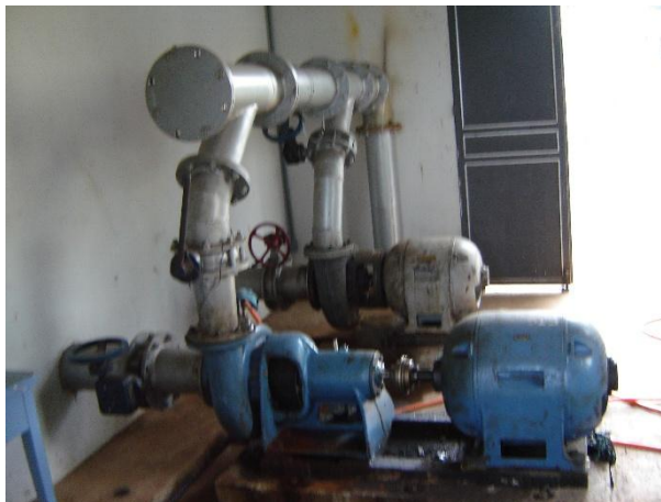
Figura 84: Elevatória de água tratada da rua Polônia para o reservatório elevado da rua Soledade.
