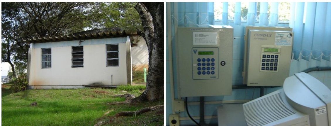
Figura 101: Antena de rádio frequência e Centro de controle.
