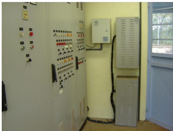
Figura 78: Quadro de comando dos motores partida por soft-start.
