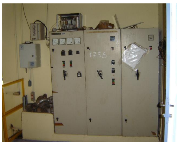
Figura 83: Quadro de comando dos motores partida direta.
