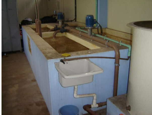
Figura 67: Reservatório de Sulfato de Alumínio Líquido.
