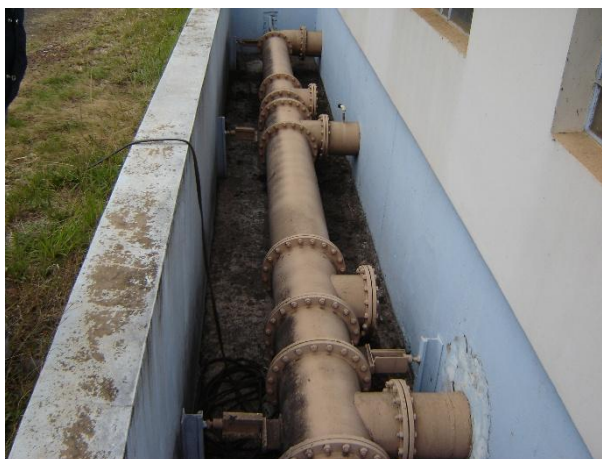
Figura 35: Tubulação de sucção \varnothing 500 mm que alimenta os 3 conjuntos moto bomba da elevatória da barragem dos rios Leãozinho e Ligeirinho.
