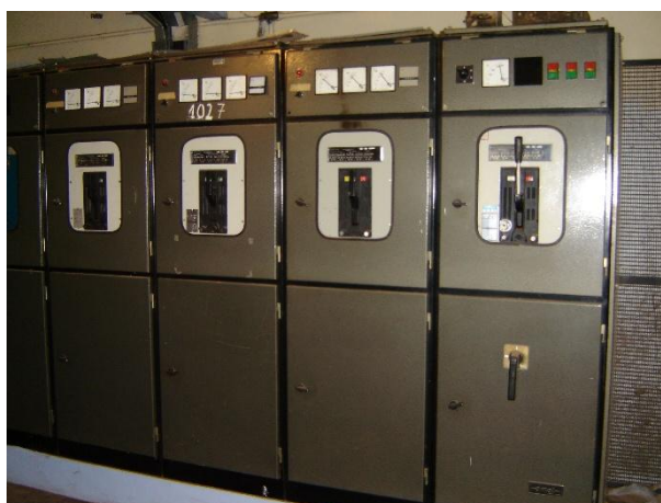
Figura 74: Quadro de comando dos motores partida direta.
