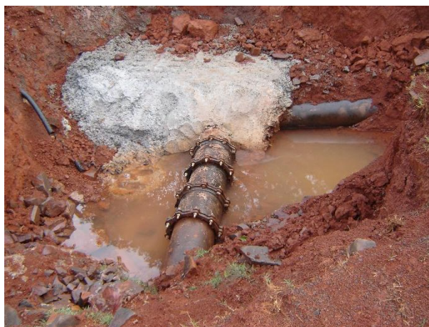
Figura 70: Adutora de recalque da ETA 2 para ETA 1.
