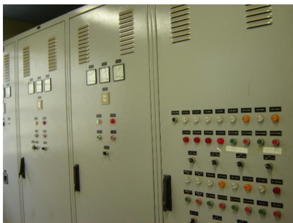
Figura 79: Quadro de comando dos motores por soft-start.
