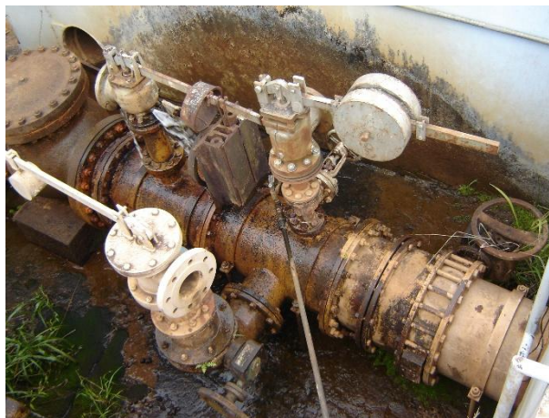
Figura 36: Tubulação de \varnothing 450 mm que transporta água bruta para a ETA 1 e o sistema de alívio de transiente hidráulico.
