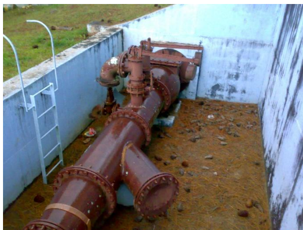
Figura 38: Tubulação de \varnothing 350 mm que transporta água bruta para a ETA 2 e o sistema de alívio de transiente hidráulico.
