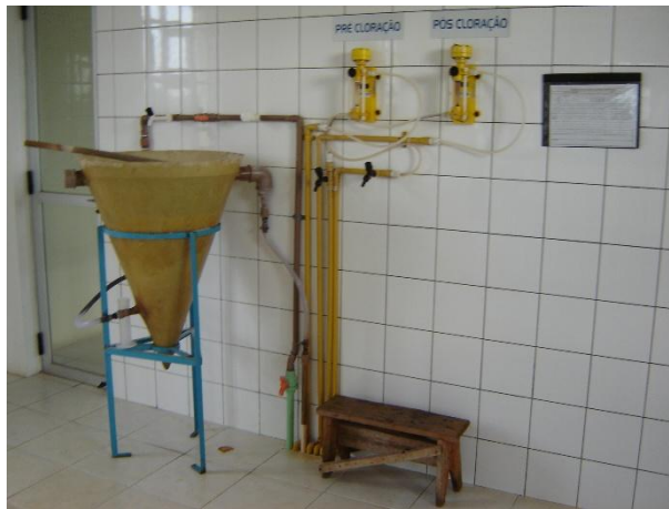
Figura 68: Dosador de Flúor e cloro gás.
