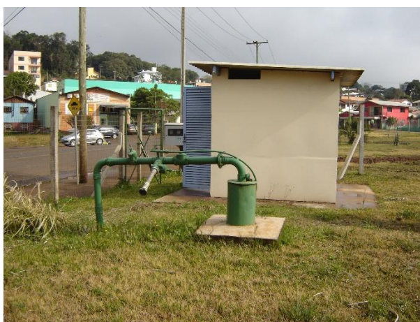
Figura 30: Poço do Aquífero Serra Geral situado à Rua José Reinaldo Andonesi.
