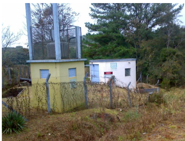
Figura 71: Elevatória de água bruta do Rio Campo.
