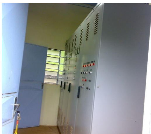
Figura 76: Quadro de comando dos motores partida por soft-start.
