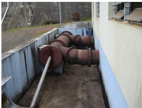
Figura 37: Tubulação de \varnothing 500 mm que alimenta os 2 conjuntos moto bomba da elevatória da barragem dos rios Leãozinho e Ligeirinho.
