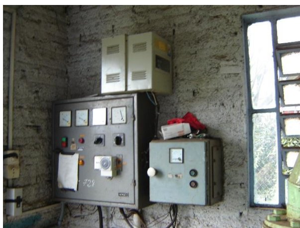
Figura 87: Quadro de comando dos motores partida por timer.
