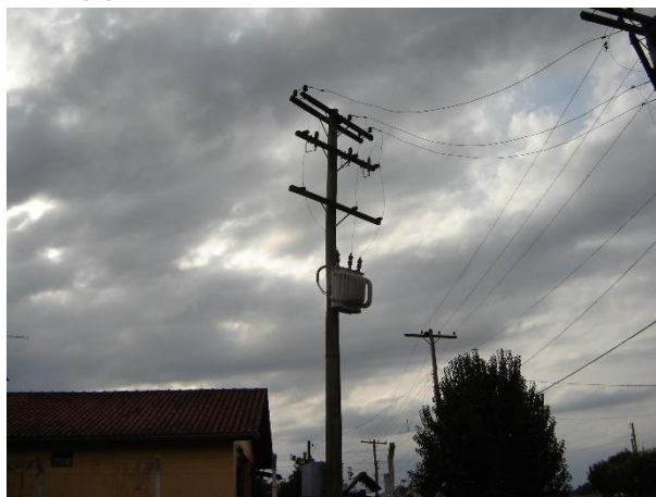
Figura 89: Transformador de tensão no booster Presidente Vargas.
