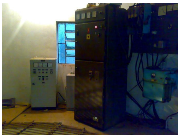
Figura 72: Quadro de comando dos motores partida direta.
