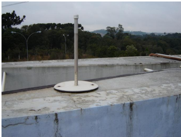
Figura 56: Calha Parshall e régua de medição do nível.
