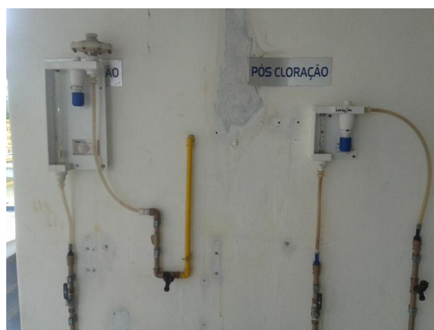
Figura 54: Dispositivo de aplicação do cloro gás.
