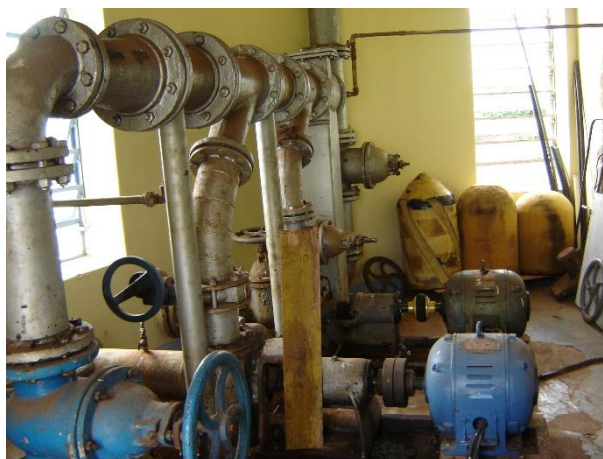
Figura 80: Elevatória de água tratada para o REL da ETA 1.
