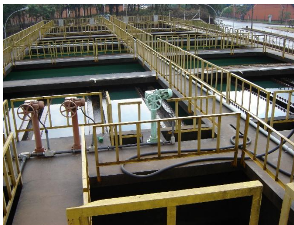
Figura 58: Decantador da ETA 2.
