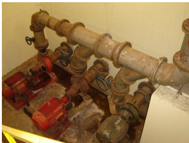
Figura 82: Elevatória de água tratada da ETA 1 para os reservatórios das ruas Portugal e Polônia.
