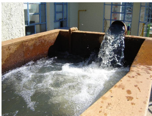
Figura 43: Chegada da água de lavagem dos filtros para reaproveitamento.
