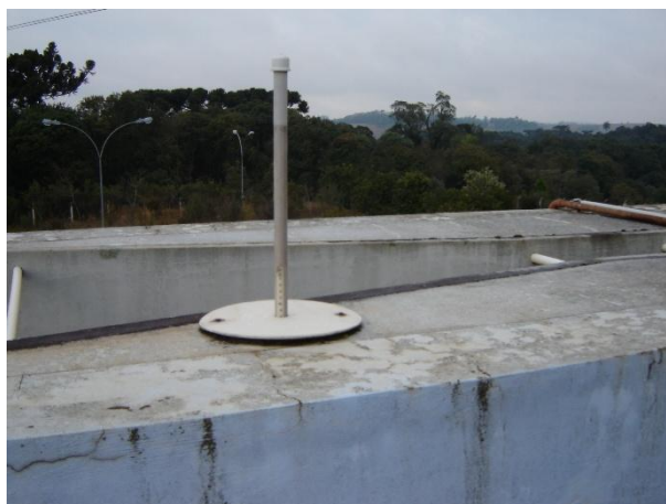
Figura 100: Régua de medição de nível na calha Parshall da ETA 2.
