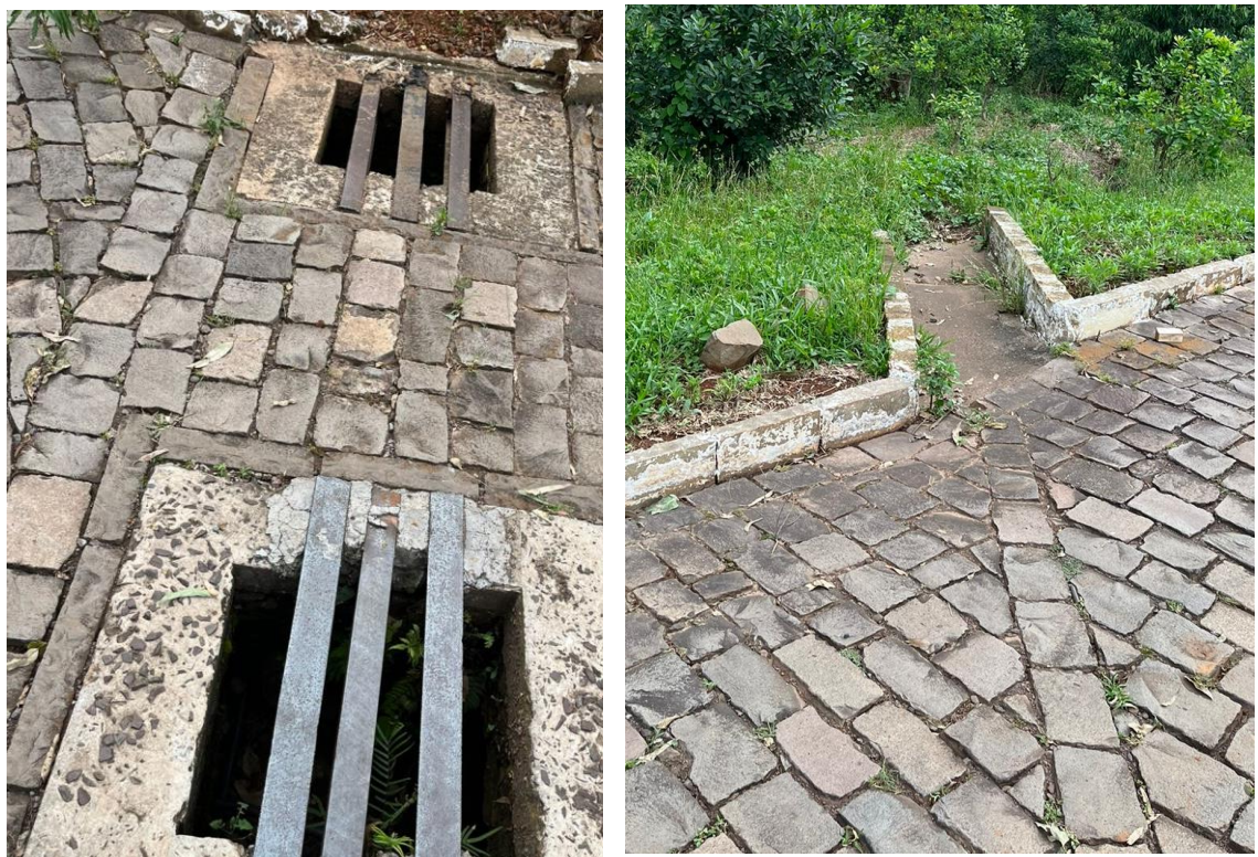
Figura 4. Sarjetas e bacias de infiltração na drenagem pluvial da empresa.
