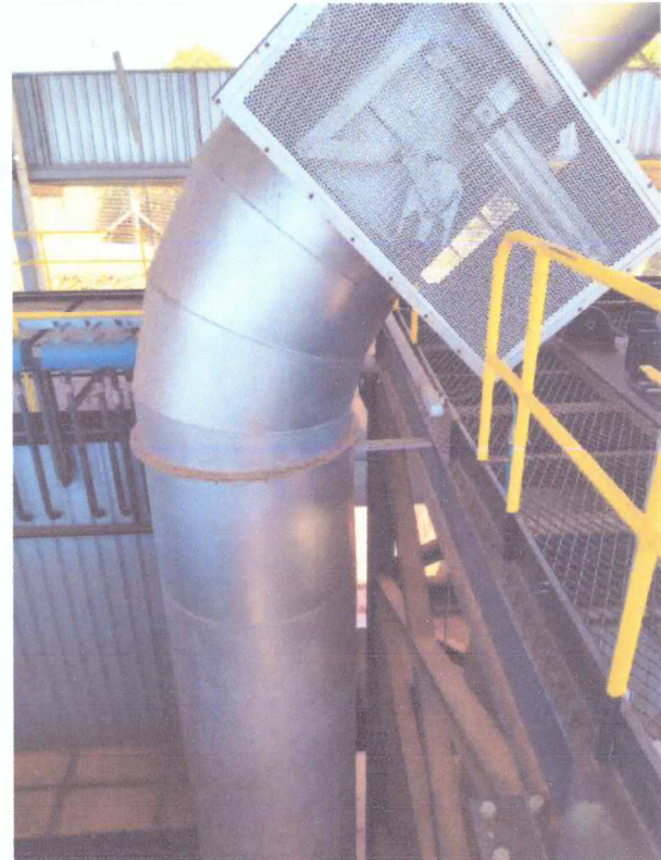
Figura 5: Última perturbação no duto de exaustão.
