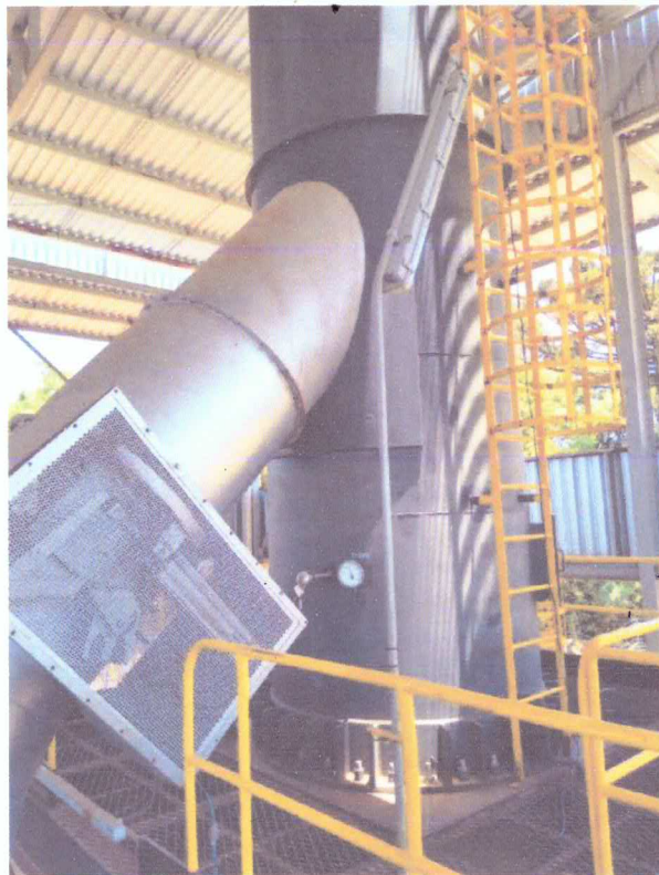
Figura 4: Última perturbação no duto de exaustão.
