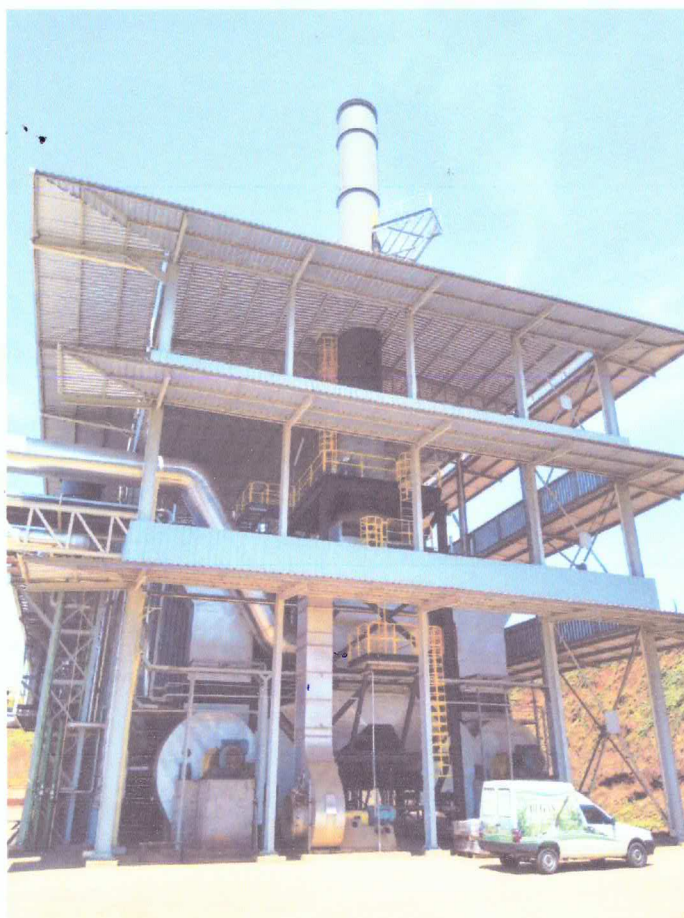
Figura 1: Caldeira e exaustão.
