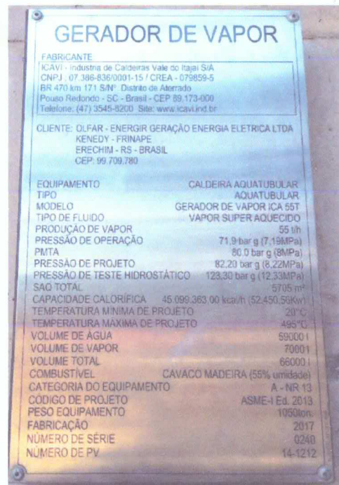
Figura 9: Placa de identificação da caldeira.
