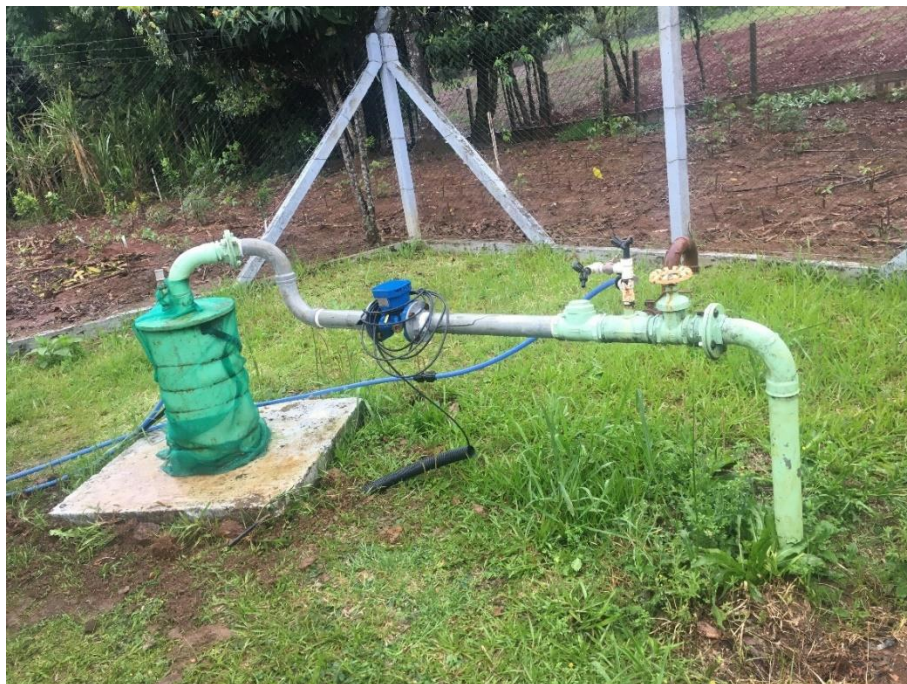
Figura 8 - Poço ERE 25 (Sede).
