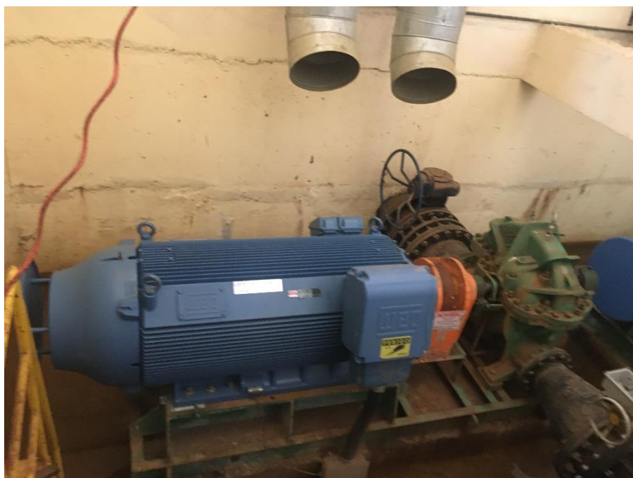
Figura 14 - Conjunto Motobomba - Rio do Cravo.
