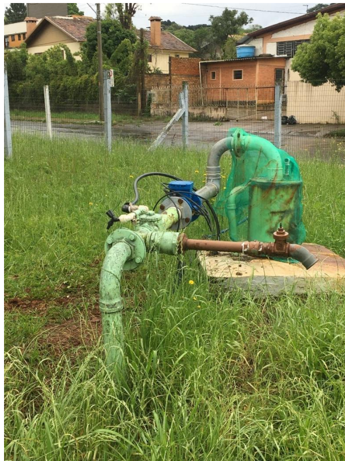
Figura 6 - Poço ERE 16 (Sede).
