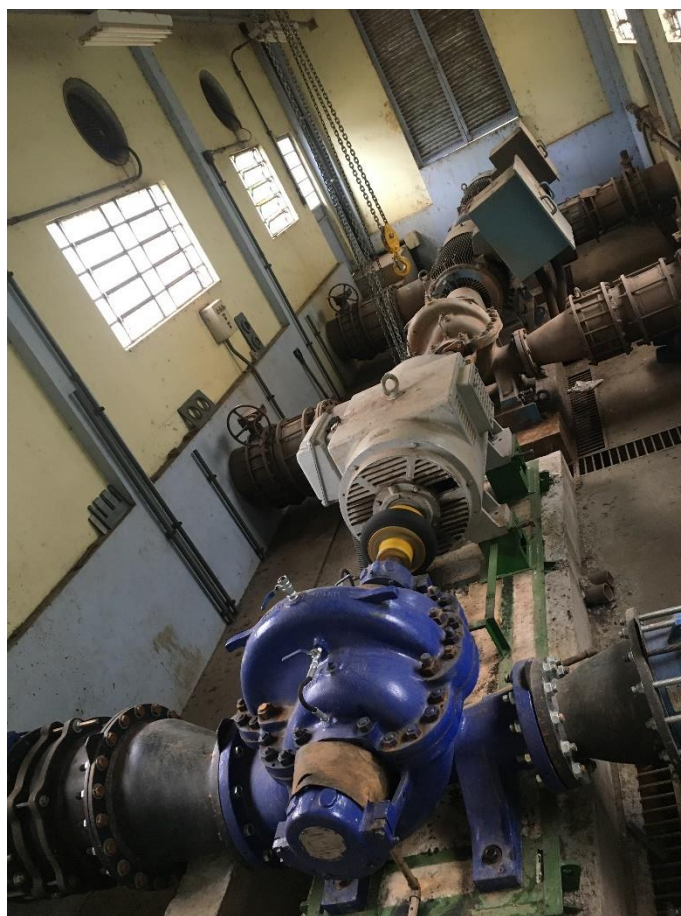
Figura 15 - Conjunto Motobomba - Barragem Ligeirinho.
