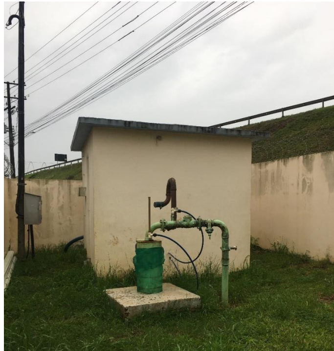
Figura 7 - Poço ERE 24 (Sede).
