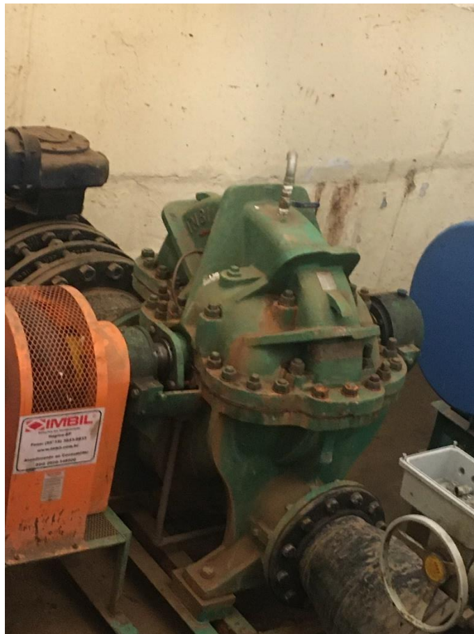
Figura 13 - Conjunto Motobomba - Rio do Cravo.
