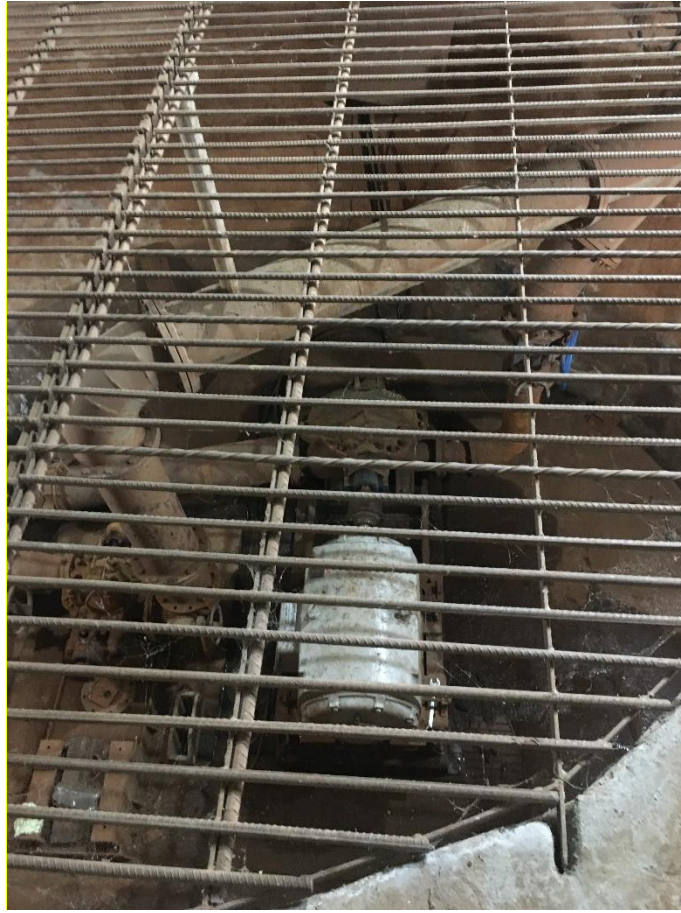
Figura 16 - Conjunto Motobomba - Rio do Campo
