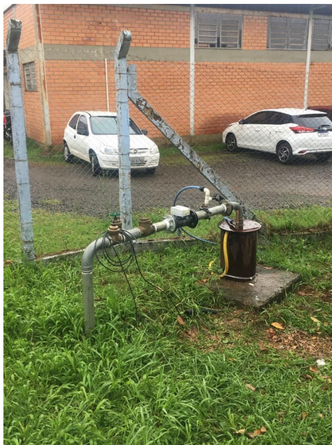
Figura 9 - Poço ERE 31 (Sede).
