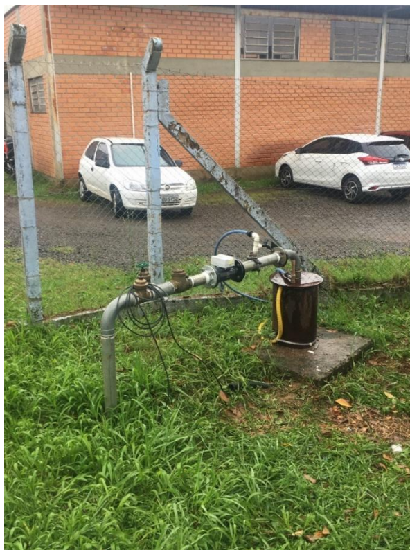
Figura 13 - Poço ERE 31(Sede).
