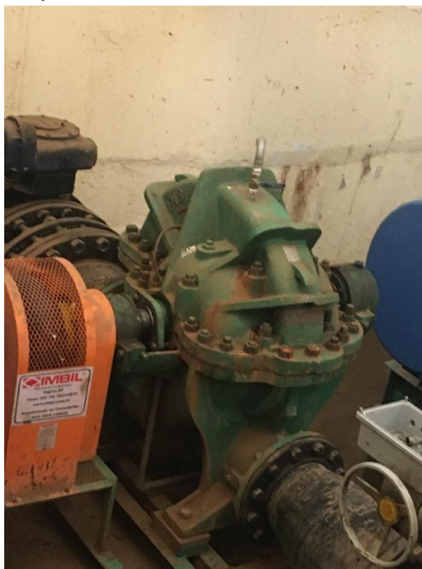
Figura 17 - Conjunto Motobomba - Rio do Cravo 1/2.
