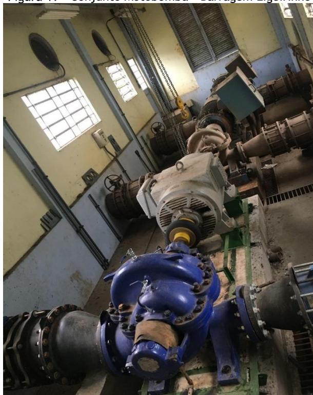
Figura 19 - Conjunto Motobomba - Barragem Ligeirinho
