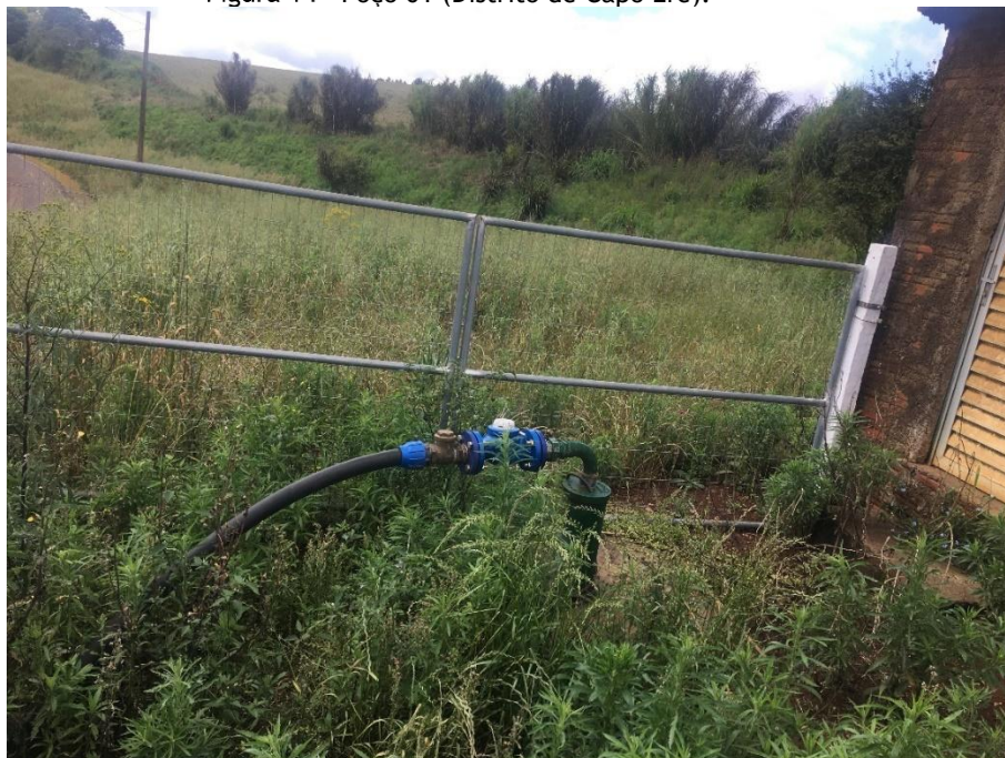
Figura 14 - Poço 01 (Distrito de Capo Erê).
