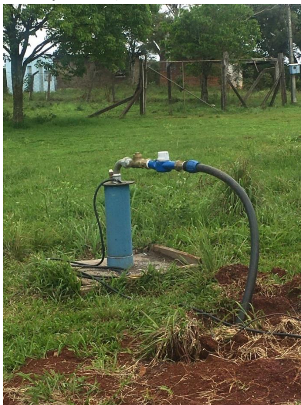
Figura 15 - Poço 02 (Distrito de Capo- Erê)
