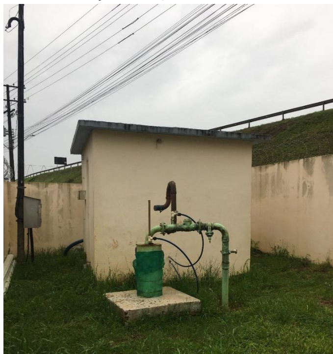
Figura 11 - Poço ERE 24 (Sede).
