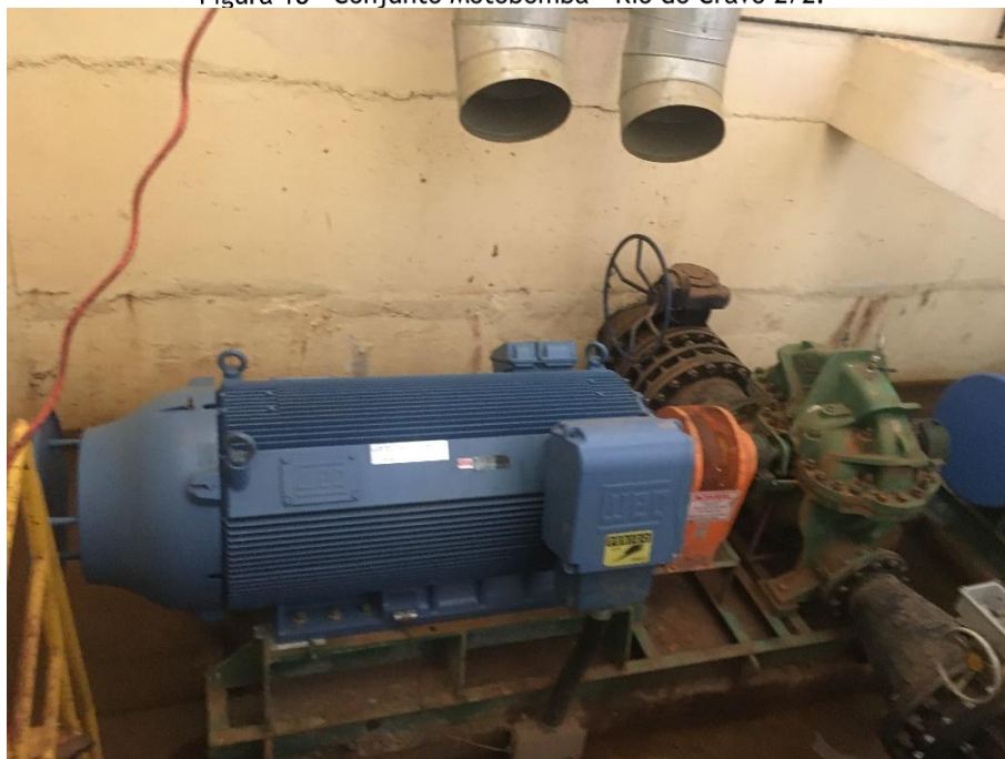
Figura 18 - Conjunto Motobomba - Rio do Cravo 2/2.
