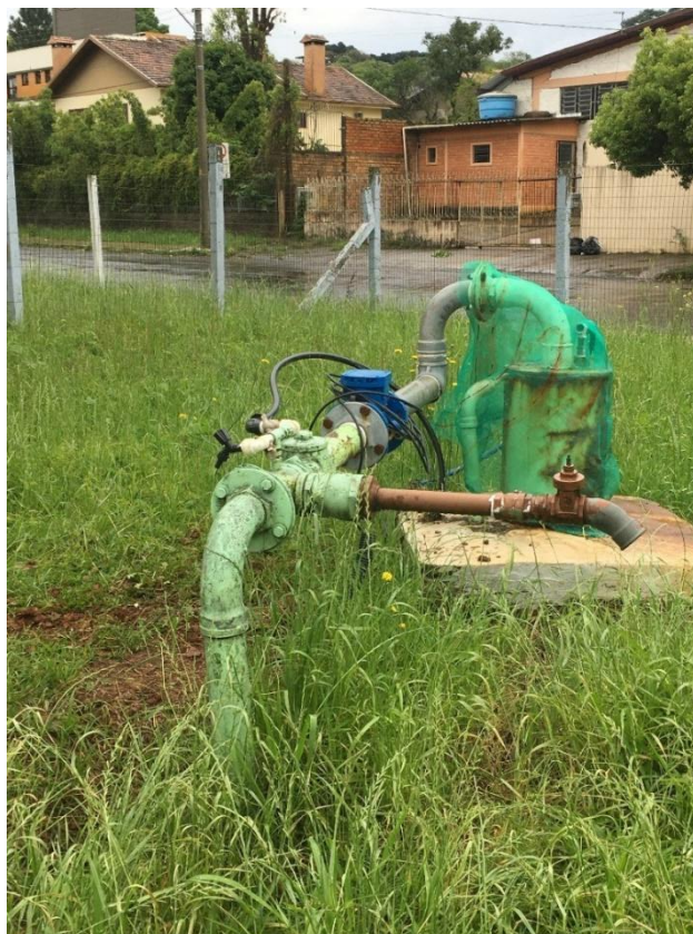
Figura 10 - Poço ERE 16 (Sede).
