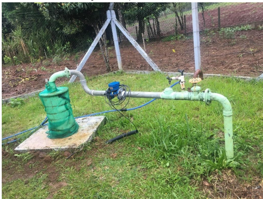
Figura 12 - Poço ERE 25 (Sede).
