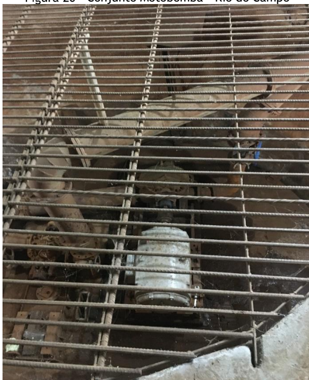
Figura 20 - Conjunto Motobomba - Rio do Campo
